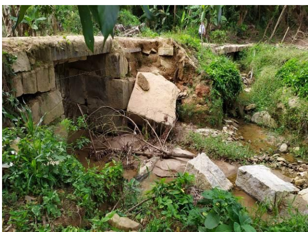
Foto 05: Nota-se a precariedade da estrutura após as chuvas de Janeiro 2020.
