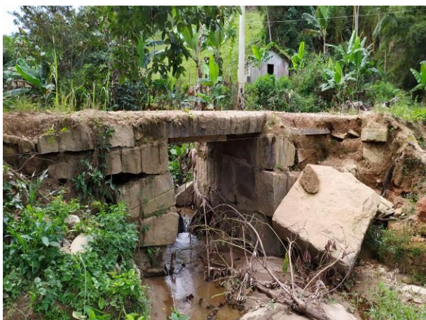
Foto 03: Vista da ponte lado a montante. Nota-se parte da estrutura arrancada pela força das águas.
