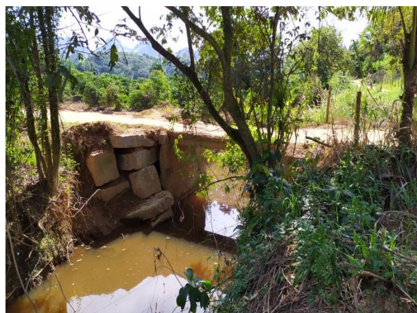
Foto 03: Vista da jusante da ponte. Nota-se que a ala do lado esquerdo foi reconstruída com blocos de granito.
