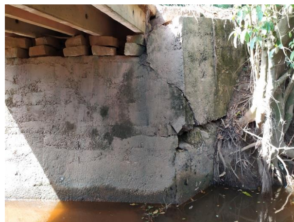
Foto 06: Vista do encontro afundado pela água da chuva. Houve a necessidade de ajustar o apoio, pois a estrutura deste lado afundou completamente.
