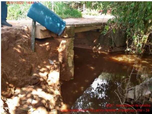
Foto 01: Vista do Local da ponte, nota-se afundamento no encontro lado esquerdo da foto.
