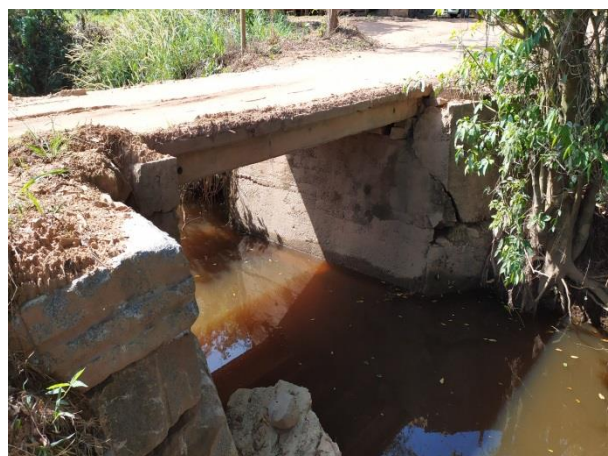
Foto 05: Nota-se o encontro reconstruído com blocos e do outro lado afundamento de todo o encontro.
