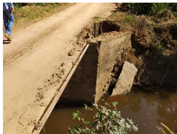
Foto 04: Vista da montante da ponte. Nota-se onde teve perca de material no encontro.
